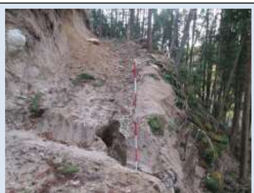
土質に適した工法を怠ると崩壊を招く
