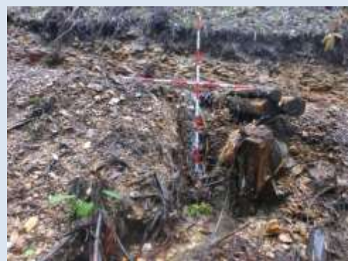
横断排水先の盛土部分が洗掘
