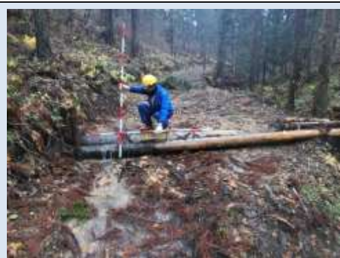
オーバーフローしている横断排水
