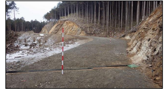
平成28年度 愛知森林管理事務所 胡麻沢林業専用道新設工事
