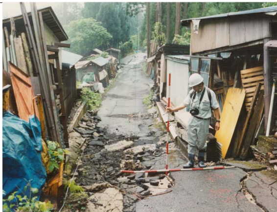
③ 市道の被災状況
