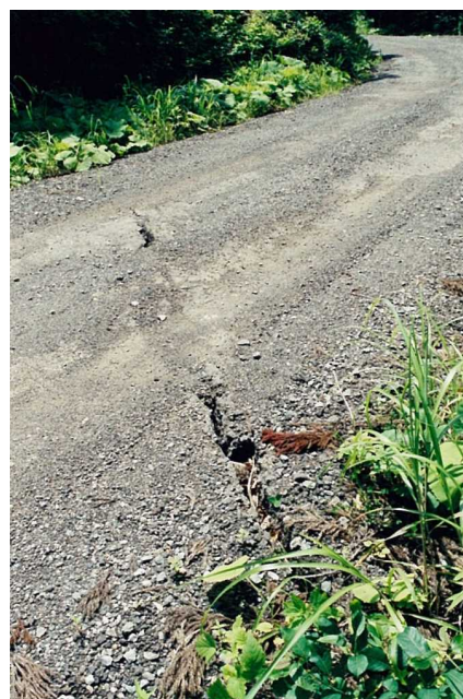
④ 作業道を横断する亀裂
