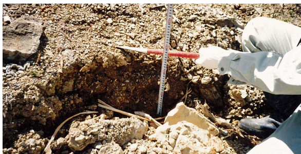
③ 冠頭部滑落崖段差
