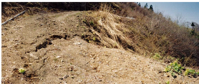
② 冠頭部を通る作業道の亀裂
