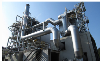
真庭バイオマス発電設備
