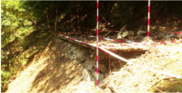
被災した林道
