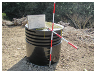
大型排水管（ポリエチレン製）
