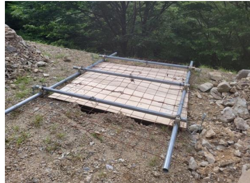
ワイヤーメッシュ等によるふた 単管で枠を組み、ワイヤーメッシュを設置する。各穴を小さく掘削することで、小さく頑丈なふたの設置を行った。
