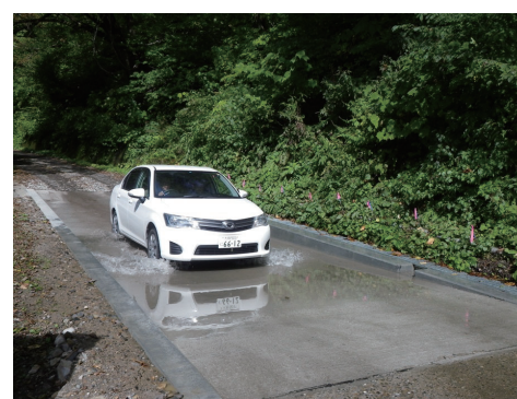
タイヤ洗浄工(資材運搬路入口)
