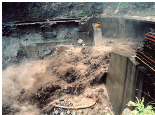
湯の谷第2号橋付近の土石の流出状況 (標高 1400m 地点)
