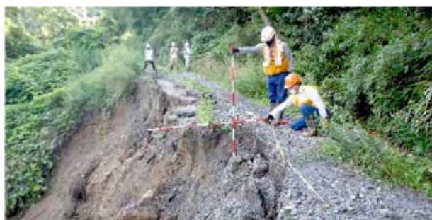
令和4年7月豪雨における被害状況調査
