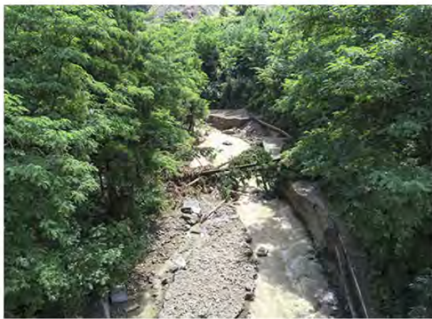
林道の被災状況をドローンにより把握
