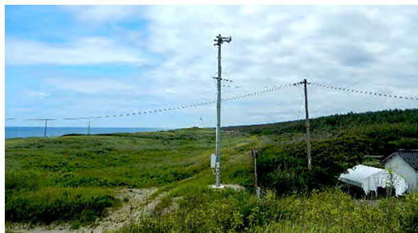
新たに設置された防災無線（中央）
