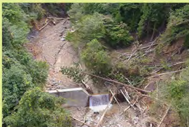
青森県風間浦村の治山施設による土砂や流木の流出抑制
